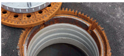
Präziser Schachtabschluss ohne Nacharbeit
